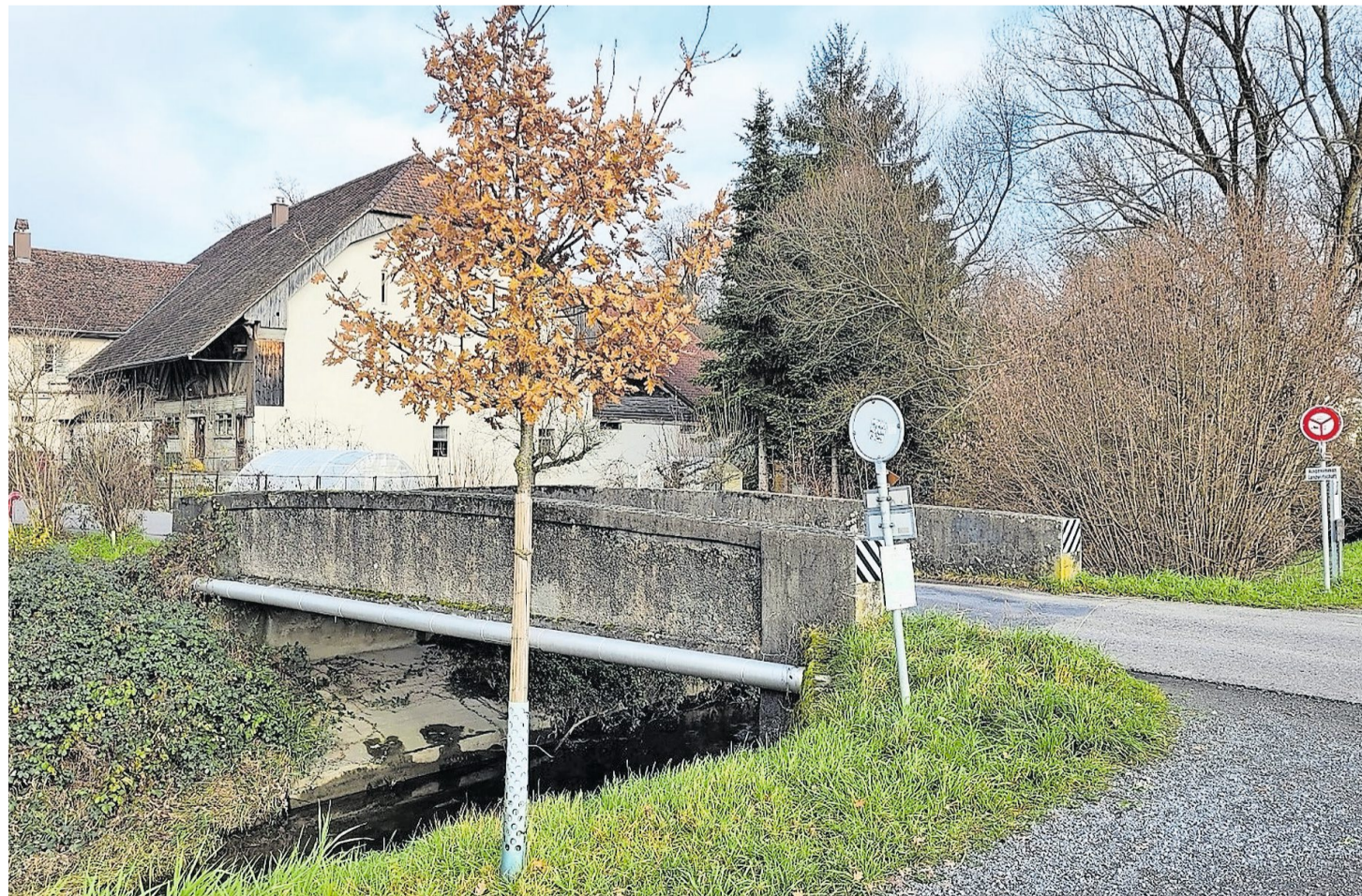
Die Tieffurtbrücke in Dottikon soll für 500 000 Franken erneuert und dann autofrei werden.
